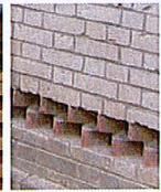
Jeux de brique créant une aération
